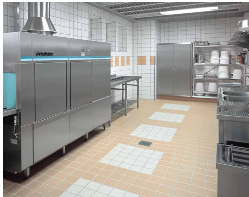
Hans-Prinzhorn-Klinik · Hans Prinzhorn Clinic, Hemer, Deutschland · Germany Architekt · Architect: Realisation GmbH, Frau · Ms. Daniel-Schrodt
